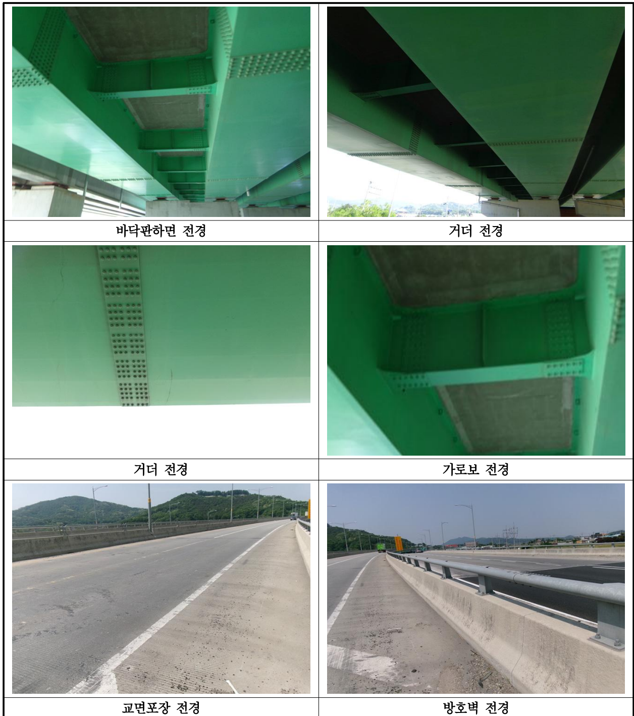
【사진 3.2.2】 상부구조 현황
